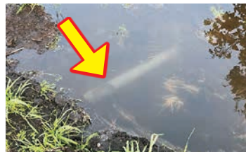
圃場内埋設管破損
