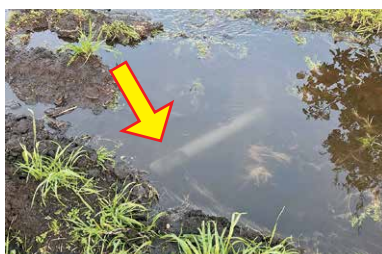
圃場内埋設管破損
