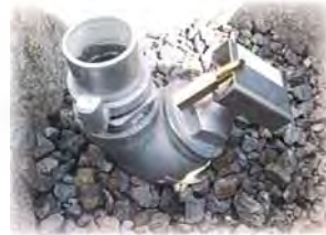
給水栓ロック後
