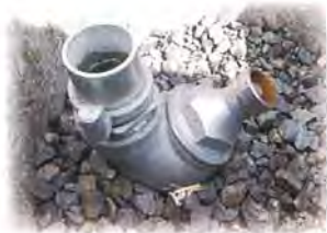
給水栓ロック前
