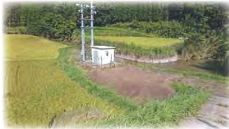
浸水した警報局
