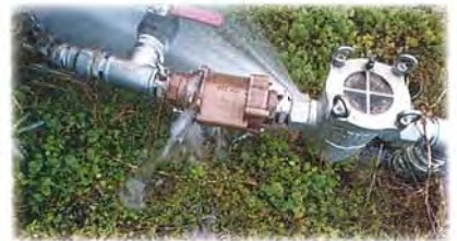
給水施設破損
