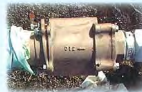
凍結による器具破損
