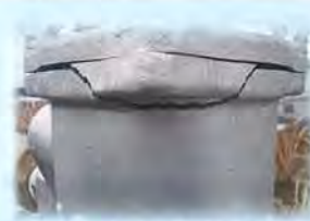
凍結による器具破損
