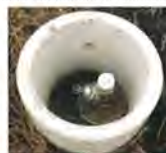
※給水栓(水道の蛇口のようなもの)
