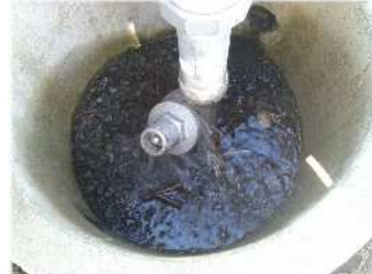
給水栓の破損
