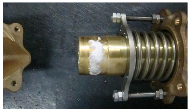
写真4-3. 噴射後の圧力調整弁内部の状況
