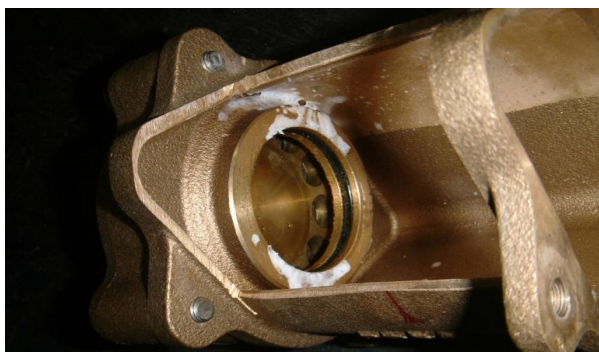
写真4-2. 噴射後の圧力調整弁内部の状況
